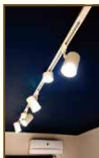
洋室・ダクトレール ダウンライト
